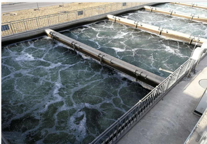
北京经济技术开发区集中污水处理设施
