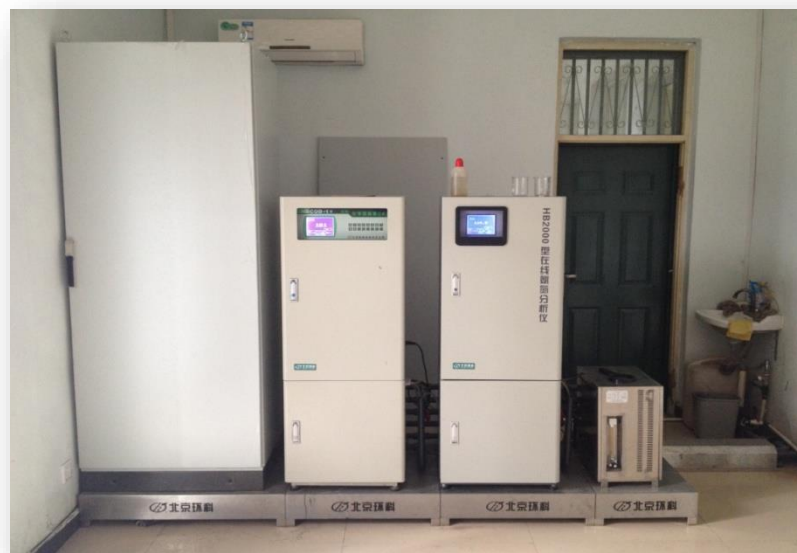
密云经济开发区污水处理设施在线监控
